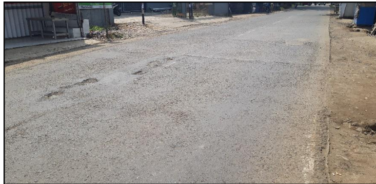
Gambar 1.1 Kondisi Jalan Batujajar, Kabupaten Bandung Barat
