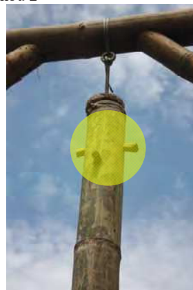
Gambar 16. Deformasi pada Bagian Atas Sambungan
