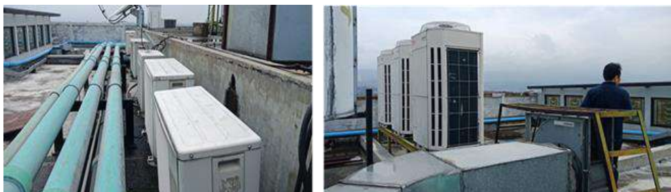
Gambar 2.69 Pipa Distribusi Air Bersih, ODU (Kiri), dan Water Cooling (Kanan)
