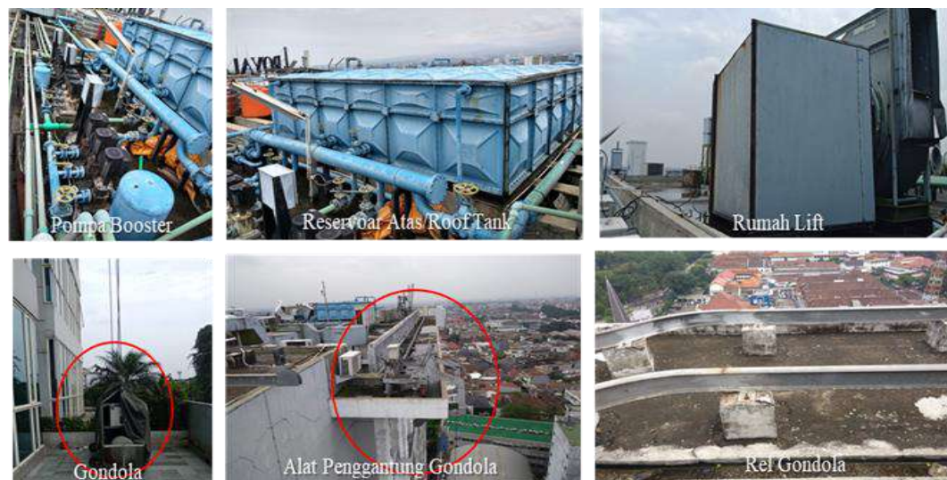
Gambar 2.70 Peralatan Utilitas di Rooftop
