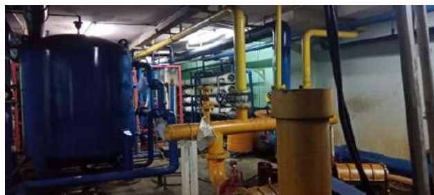
Gambar 2.53 Ruang GWT dan Pompa (Sumber: Survey 22 Februari 2019)
