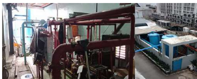
Gambar 2.58 Ruang Pompa Kebakaran (Kiri) dan GWT Untuk Kebakaran (Kanan)
