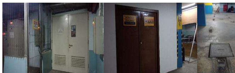
Gambar 2.52 Ruang Panel Listrik (Kiri), Gudang Workshop (Tengah), dan Sampit (Kanan) (Sumber: Survey 22 Februari 2019)
