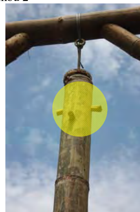
Gambar 16. Deformasi pada Bagian Atas Sambungan
