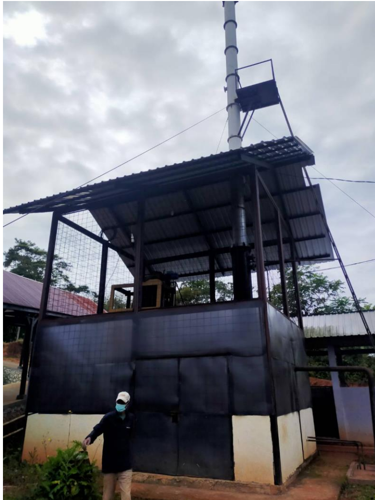
Gambar 4. 13. Fasilitas Incinerator RSUD Pongtiku (Sumber: Hasil survei, 2022)
