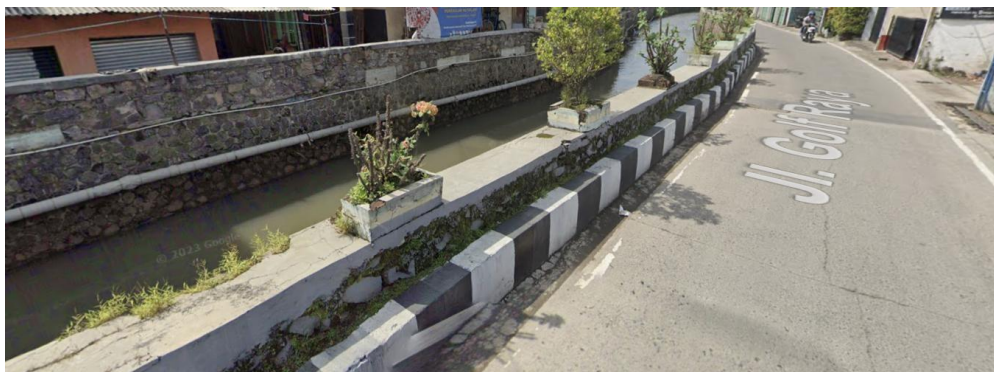
Gambar 1. Kondisi dinding survey awal
