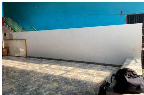
Gambar 2.1. Kondisi dinding saat survey awal
