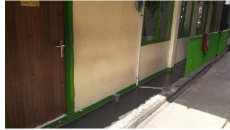
Gambar 10&11. Kondisi eksisting sebelum
