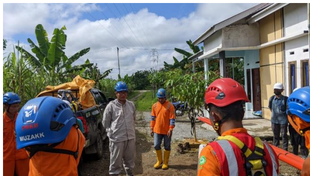
Gambar 4. 3 Penggunaan APD Pada Saat Ganti Isolator Sumber : PT. PLN (Persero) UP3B Sistem Kalbar, 2021
