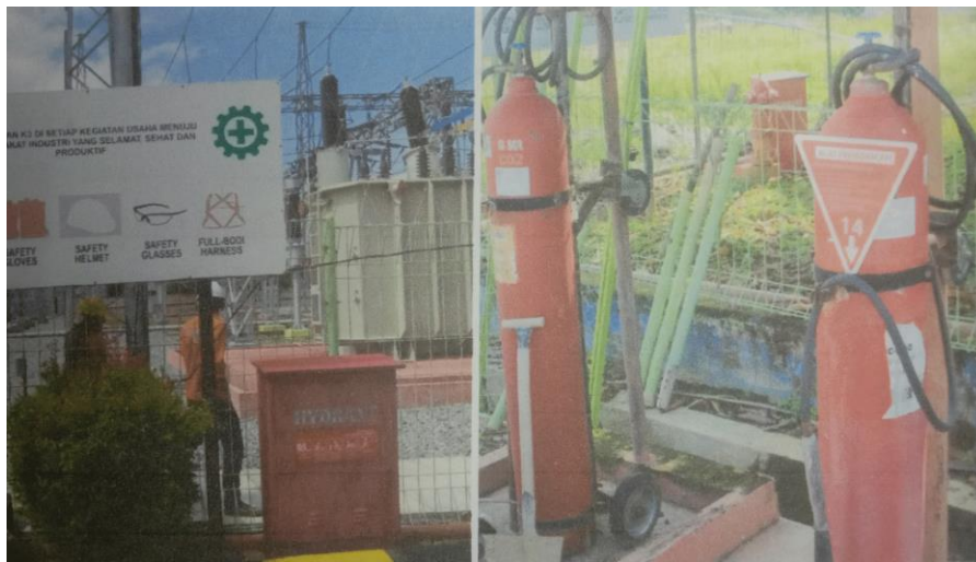
Gambar 2. 3 Hidran dan APAR
