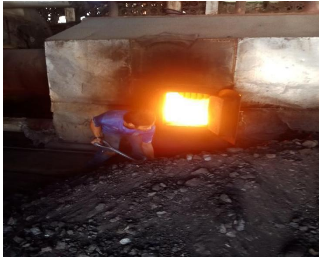
Gambar 2. 6. Tungku Pemanas Boiler
