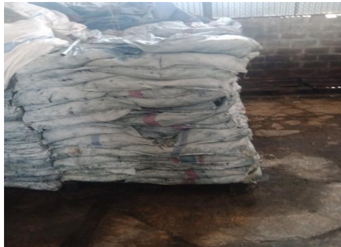
Gambar 4. 11 Retakan Lantai TPS Limbah B3
