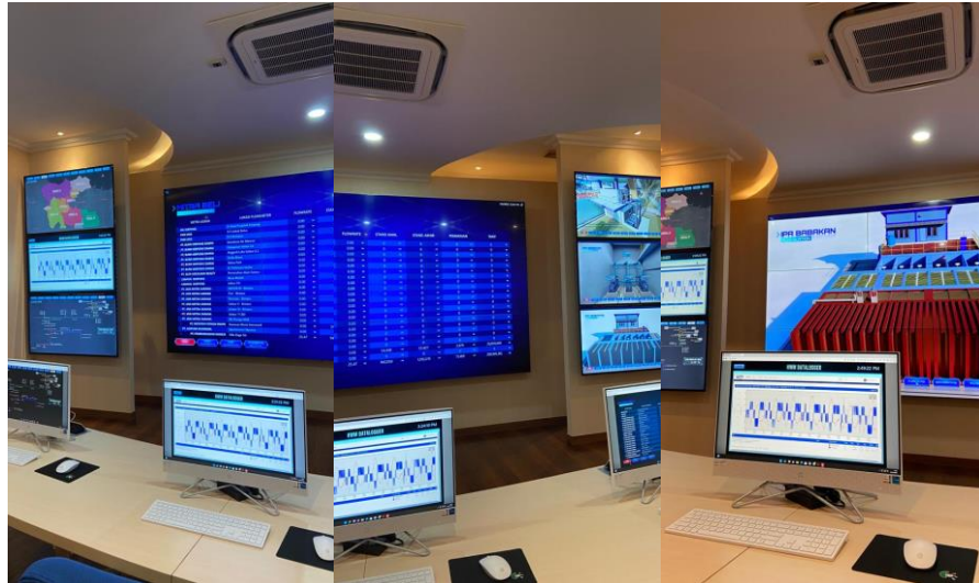
Gambar 4. 10 Ruang Pengoperasian dan Pemantauan SCADA IPAM Babakan
