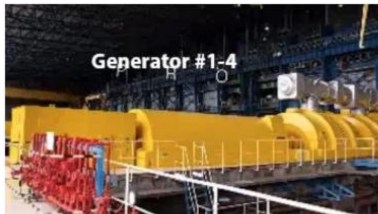
Gambar 3. 10 Generator Pada Unit 1-4
