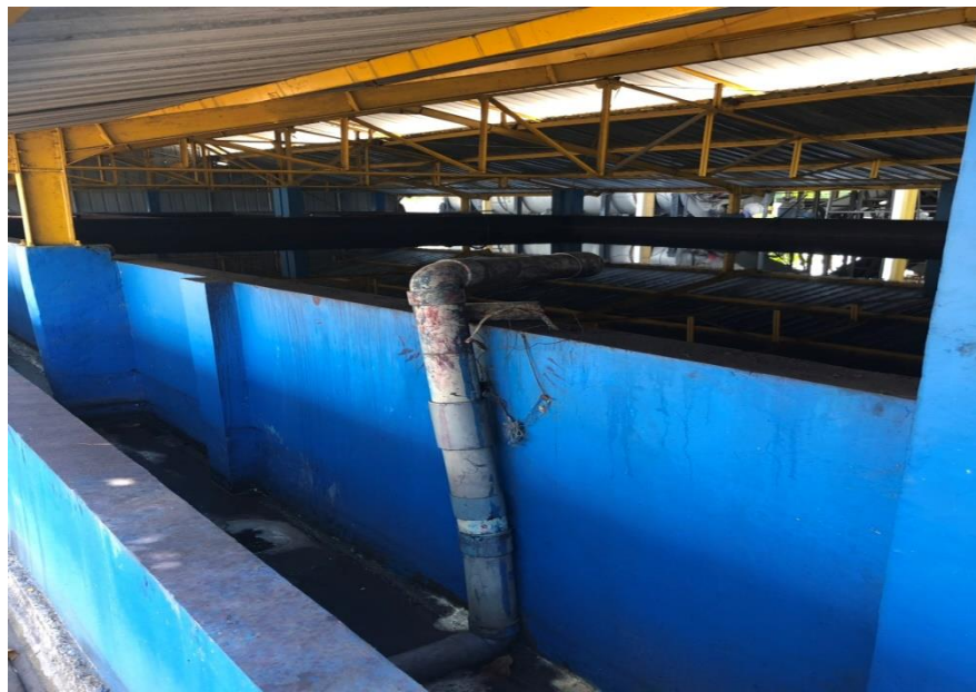
Gambar 4.6 Bak Penampung Limbah B3 Cair dari Gedung Cetak Uang Kertas
