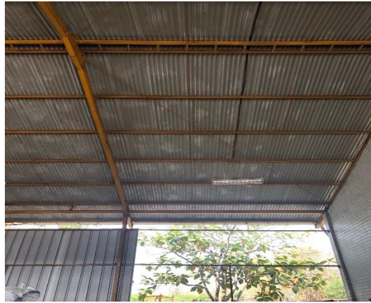
Gambar 4.18 Kondisi atap, ventilasi dan penerangan pada TPS limbah B3
