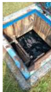
Gambar 4. 16 Kondisi Penuh Salah Satu Bak Reservoir R-XII
