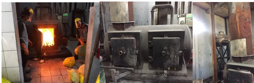
Gambar 2.5 Insinerator Rumah Sakit Umum Daerah Dr. Iskak Tulungagung
