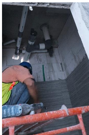
Gambar 5. 10 Pemasangan Pipa Air Kotor Pada Proyek Pembangunan Gedung Kantor DPRD Provinsi Jawa Tengah
