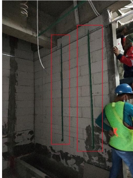
Gambar 5. 5 Jalur Pipa Air Bersih Pada Tempat Wudhu
