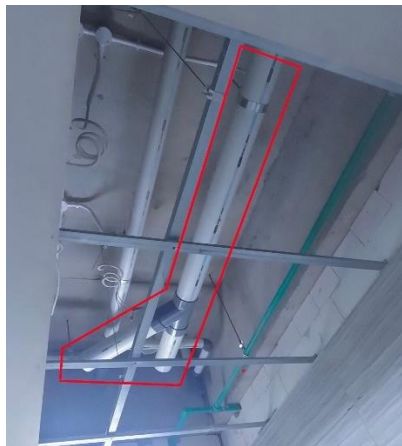
Gambar 5. 9 Jalur Pipa Air Kotor Water Closet Pada Kamar Mandi Wanita
