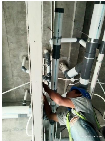
Gambar 5. 13 Pemasangan Pipa Air Bekas Pada Proyek Pembangunan Gedung DPRD Provinsi Jawa Tengah
