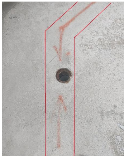
Gambar 5. 17 Drainase dan Lubang Penyaluran Air Hujan Pada Proyek Pembangunan Gedung Kantor DPRD Provinsi Jawa Tengah
