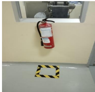
Gambar 4.26 Pemasangan Alat Pemadam Api Ringan yang Sudah Sesuai dengan Peraturan
