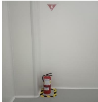
Gambar 4.25 Pemberian Tanda Pemasangan Alat Pemadam Api Ringan yang belum Sesuai dengan Peraturan (Sumber: Hasil Dokumentasi, 2019)
