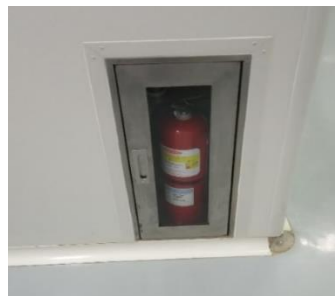
Gambar 4.27 Pemasangan Alat Pemadam Api Ringan yang Belum Sesuai dengan Peraturan
