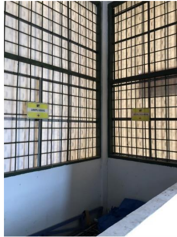
Gambar 4.28 Ventilasi pada TPS Limbah B3
