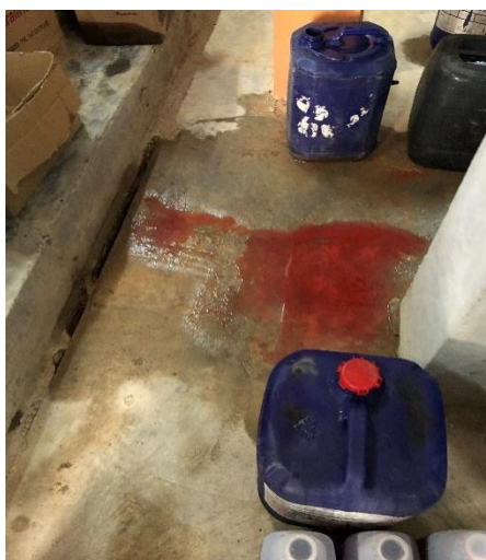
Gambar 4.9 Tumpahan Bahan Bakar Genset di Ruang Genset RSBP
