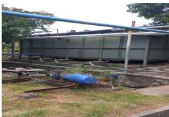
Gambar 5. 49 Bak Sedimentasi untuk Pengolahan Kimia yang Belum Beroperasi
