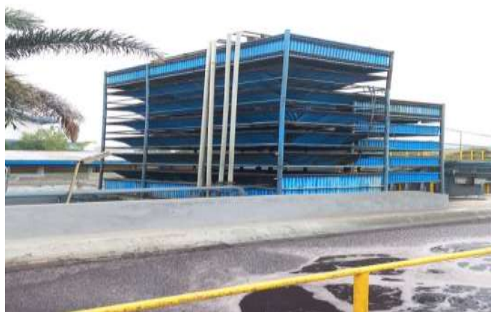
Gambar 5. 16 Cooling Tower di PT X
