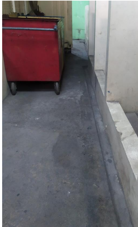
Gambar 4. 6 Kondisi Lantai di dalam TPS Limbah B3 PT Nikkatsu Electric Works
