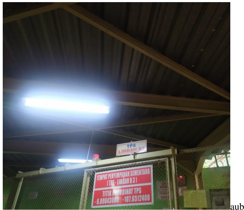
Gambar 4. 5 Sistem Pencahayaan pada TPS Limbah B3 di PT Nikkatsu Electric Works
