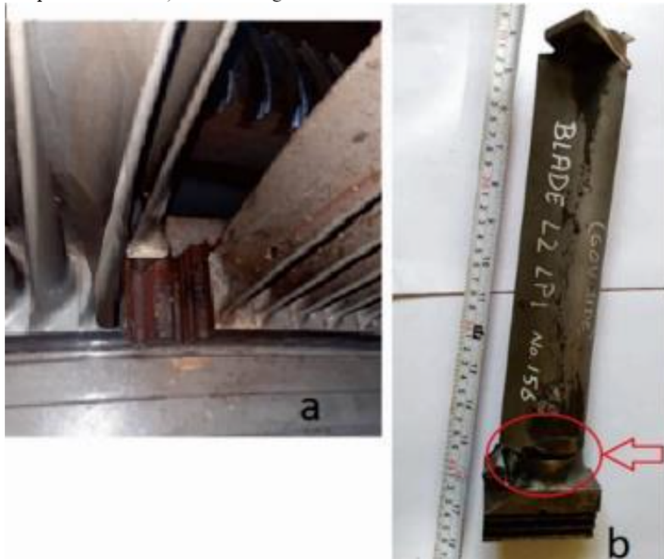
Gambar 3. (a) lokasi kegagalan terjadi, (b) blade yang patah (tanda panah).
