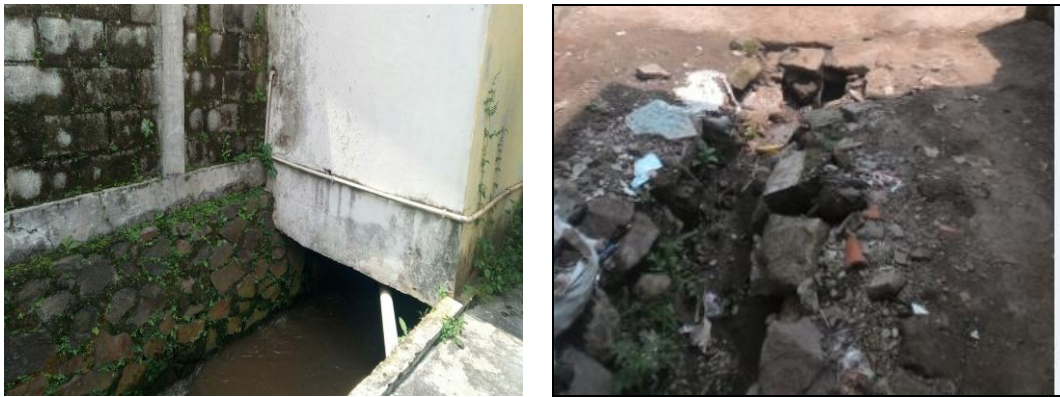
Gambar 2. Kondisi Saluran Drainase
