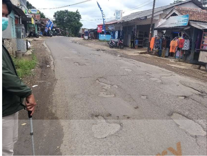
Gambar 1.1. Kondisi jalan Rendeh – Cikalong , Kabupaten Bandung Barat
