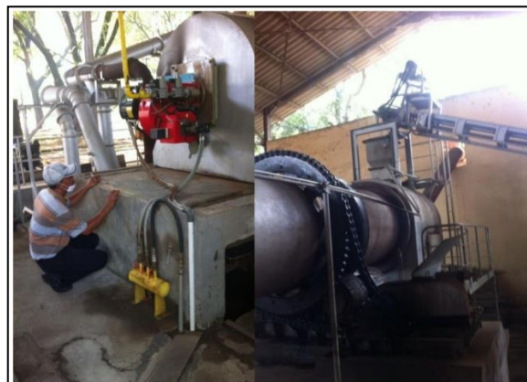
Gambar 2.4 Mesin Pembakaran Agregat
